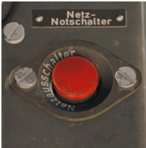
图 70: 电气系统切断开关
